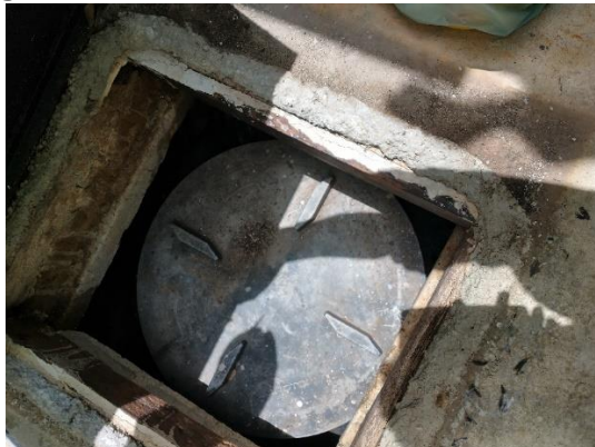
Imagen 5. Sistemas de almacenamiento del agua
