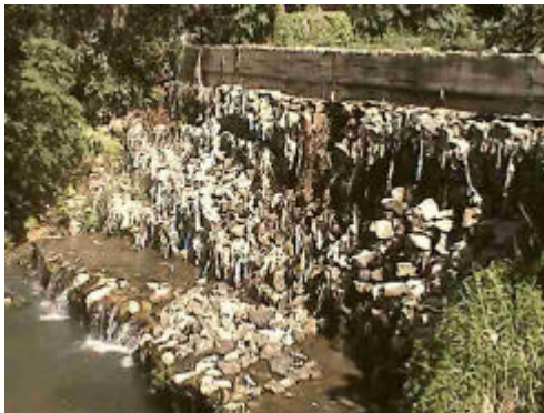
Figura 3. Presa Gavión azolvada.
