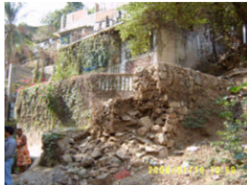
Figura 4. Presa Gavión: Daños por vandalismo.
